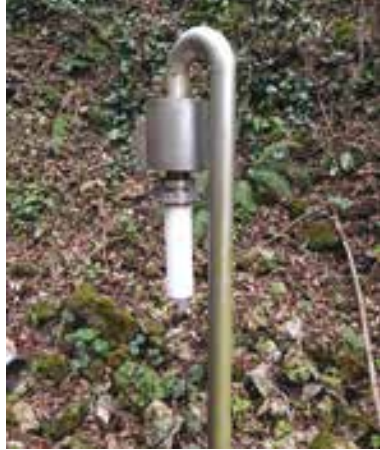
Resim 2: Kaptaj havalandırma bacası 0.2 mikron hava filtrelidir.
