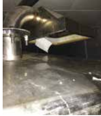
Resim 3: Paslanmaz Depoda uygun olmayan hava filtresi kullanımı.
