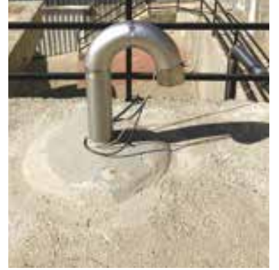
Resim 4: Paslanmaz Depo-Hava uygun olmayan hava filtresi kullanımı.
